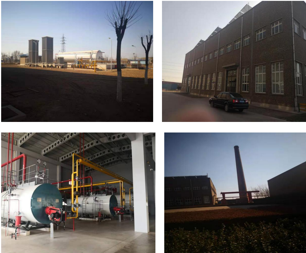
图 1 LNG 储罐和锅炉房
