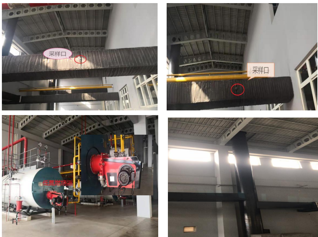
图 1 废气采样口、低氮燃烧器和排气筒
